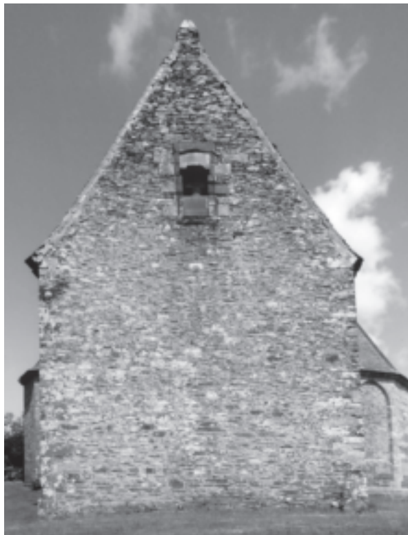
Fig. 2. – Façade occidentale reconstruite en médiocres moellons. Cliché L. Chauris (4 août 2014).
