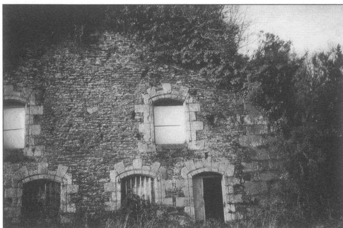
Fig. 17. – Guilers, fort de Penfeld, moellons de gneiss et pierres de taille en granite de l'Aber-Ildut, dans le casernement sous l'emprise de la végétation. Cliché L. Chauris.
