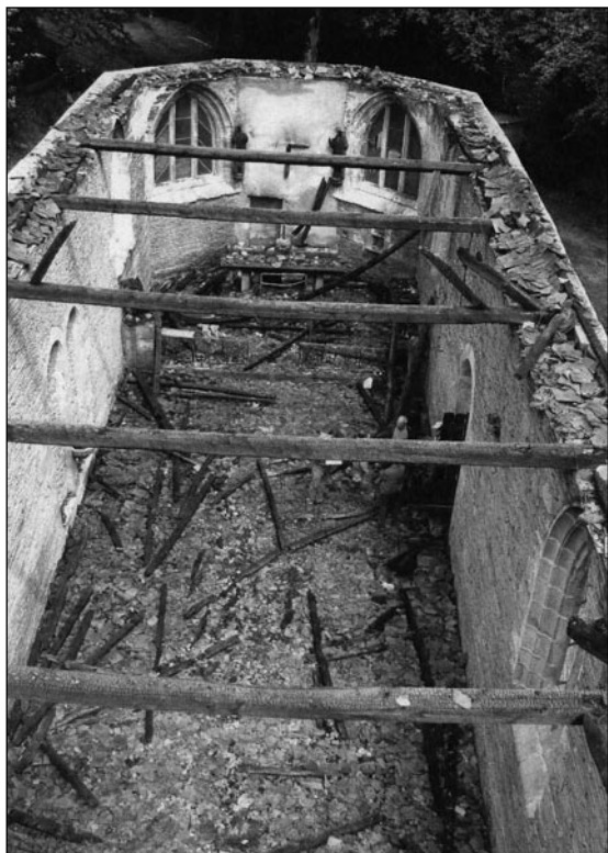
Fig. 18. – La nef après l'incendie du 16 juin 2007. Cliché B. Le Moën.
