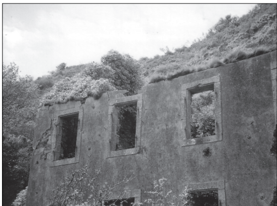
Fig. 38. – Bâtisse ruiniforme aux approches de la batterie basse.
